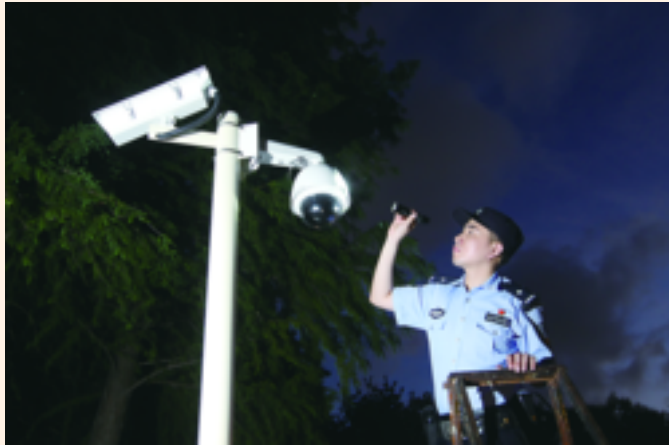
民警检查视频监控
