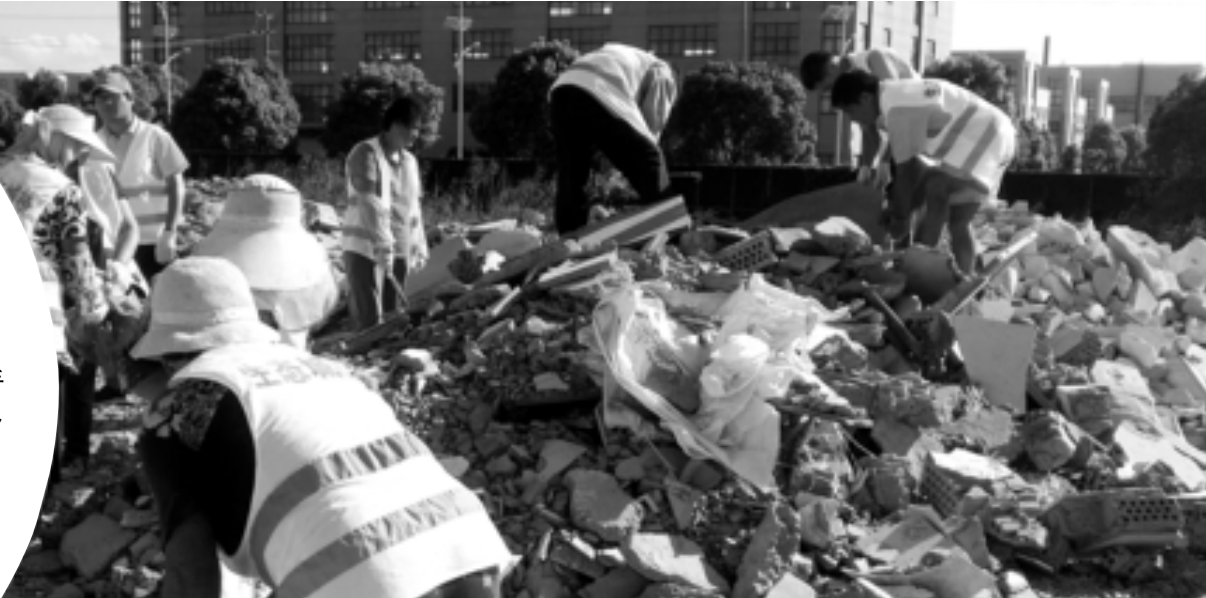
特殊人员在城桥镇混合垃圾堆放点工作
