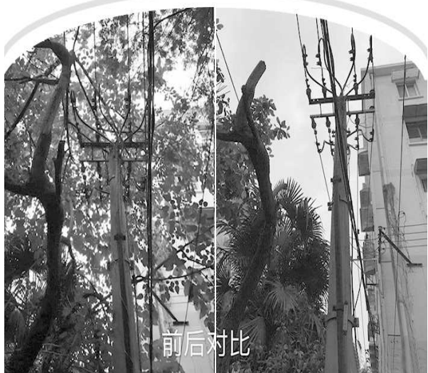
左半边为整改前，小区树木树枝与架空电线发生缠绕，隐患重重；右半边为整改后，经对缠绕树枝全部修剪，小区隐患消除
