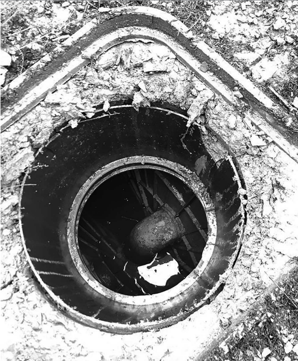
化粪池内明显变形的隔板
