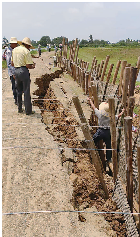
黄佃圩堤坝坝体多处出现裂缝和渗水
