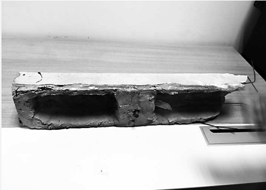
掉落的外墙装饰物
