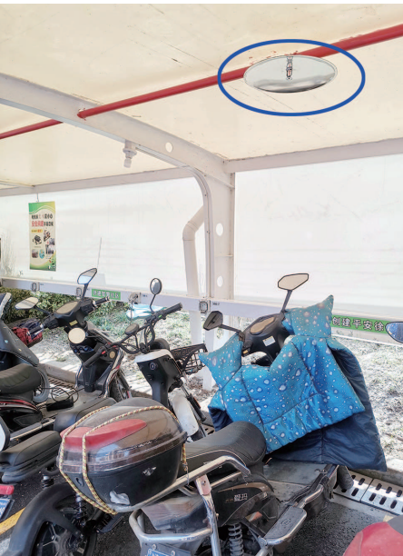
电动车充电棚内加装的喷淋装置
