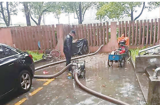
闵行昆阳小区排查地下管道溢水问题
