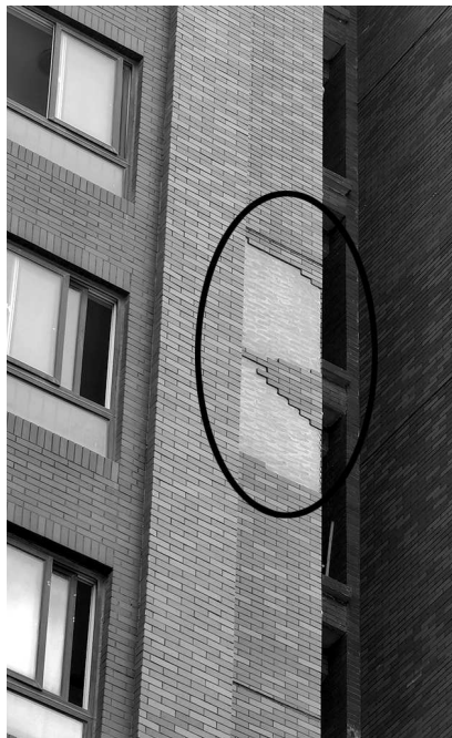
小区内脱落的外墙面
