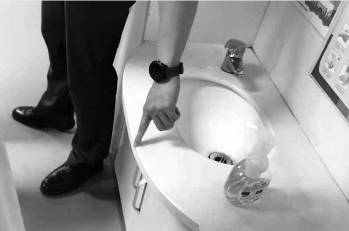
硬，存在安全隐患 整改前的洗手池边缘部位棱线分明且材质坚
