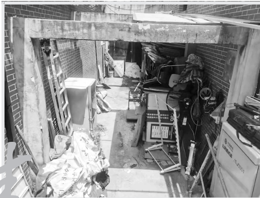
山阴路公共区域违法搭建阻塞消防通道
