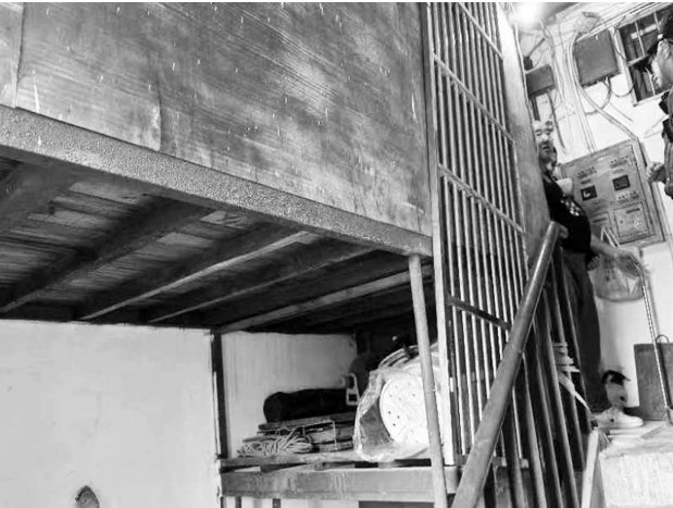
悬空在6楼楼道尽头的违法搭建
